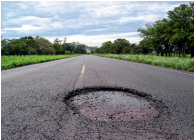
Schadhafte Fahrbahndecke einer Landesstraße
